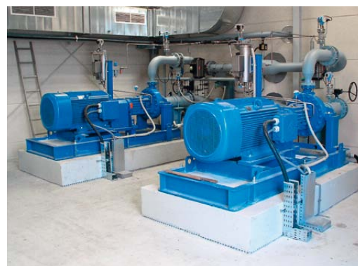
Transportpumpen für den Solbetrieb
